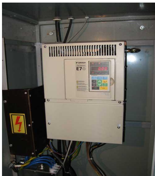
Sl. 4. Frekventni regulator postavljen na crpnoj stanici za potrebe eksperimentalnog postrojenja
